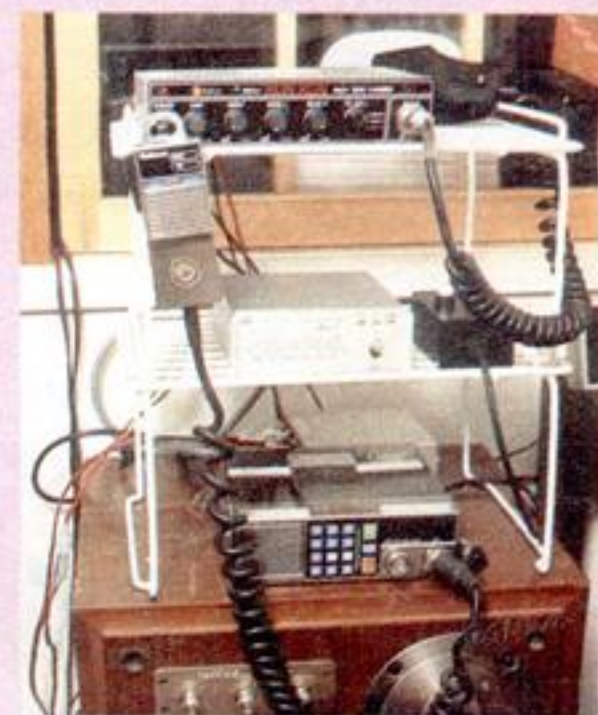
◆FM局の一角に置かれたパーソナル無線機。アンテナは屋外に設置してある。
